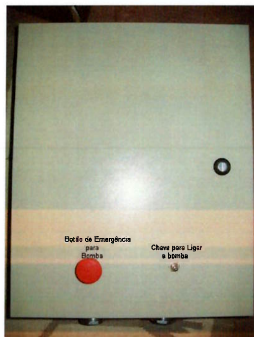
Figura 52 – Painel Elétrico – Frontal
